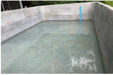
ภาพที่ 1 บ่อพักน้ำ
